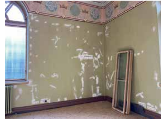
Seinissä oli yllättävän paljon halkeamia, kun niitä päästiin tarkastelemaan lähempää. SF
