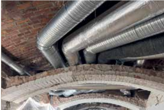
Ilmanvaihtokanavia holvikaarien päällä. Väli­tilassa on kulkenut ilmaa alun perinkin höyrykoneilta huoneisiin. SF
