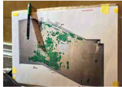
Kiinnitystyön johdonmukainen kartoitus on auttanut ymmärtämään vaurioitumisen etenemisen tavan ja ohjannut työtapojen valintoja.
