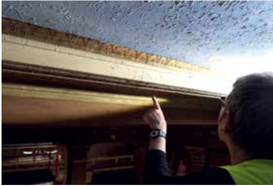
Porvariston ja talonpoikien salien kattomaalaukset hilseilevät pahasti, mikä johtuu maalipinnan alla olevan kittikerroksen haurastumisesta. KW
