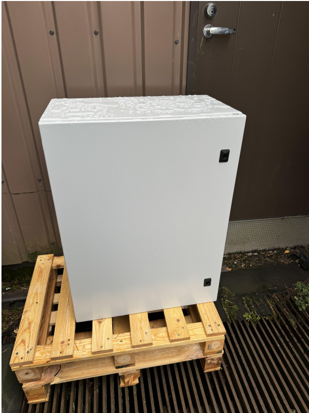
Liite 4. Ulkotiloissa olevan akkuenergiavarasto B:n suojalaatikko. (Vähimaa, 2024)
