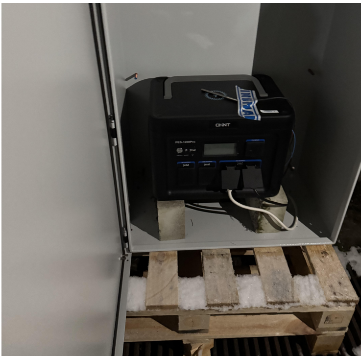
Liite 5. Ulkotiloissa oleva akkuenergiavarasto B. (Vähimaa, 2024)
